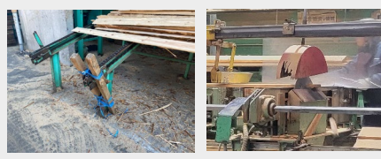
壊れた状態 応急処置のまま
