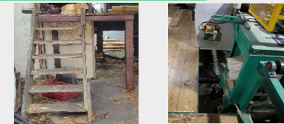
手すりの未設置
