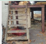
手すりの未設置
