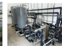
木質資源利用ボイラー
