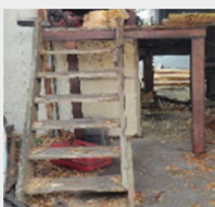
手すりの未設置
