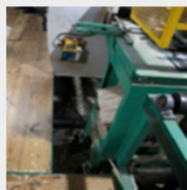
開口部がある 足場が不安定
