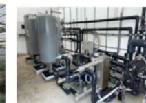
木質資源利用ボイラー
