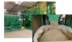
ペレット製造施設及びペレット
